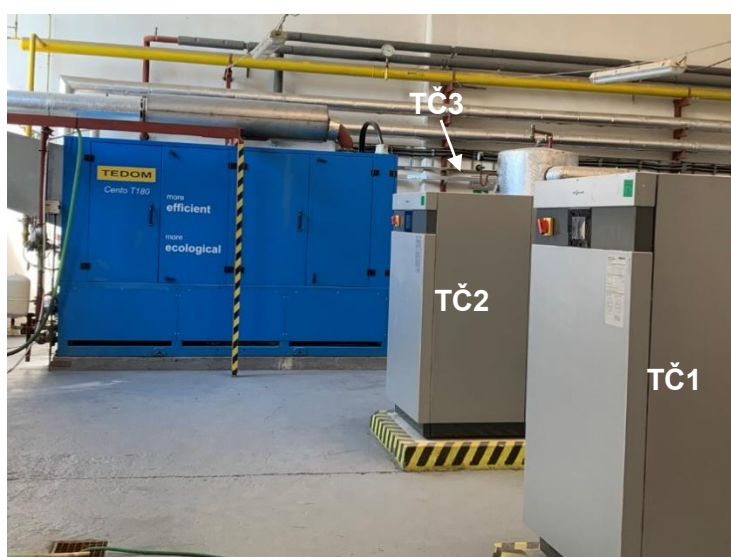
Obrázok 12: Technológia kotolňa K5 – kogeneračná jednotka a tepelné čerpadlá
