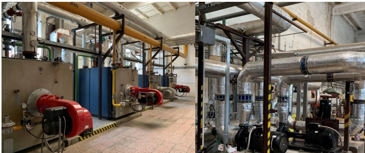
Obrázok 10: Technológia kotolňa K5 – kotly a obehové čerpadlá
